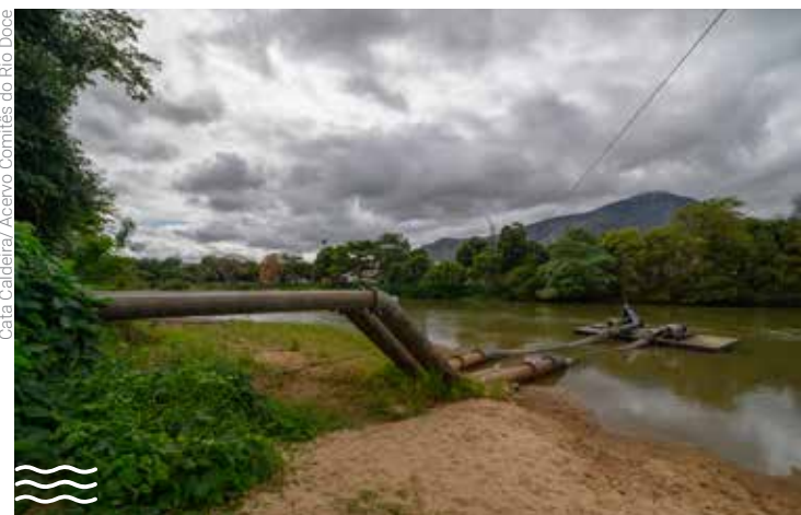
Sistema de Captação de Água, em Governador Valadares/MG
